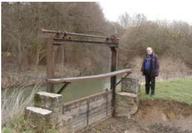
Bild: Das Dammbalkenwehr im Nidderdamm bei Lindheim
