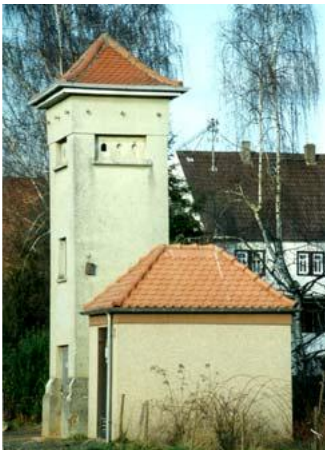
Bild: Trafohäuschen in Himbach
